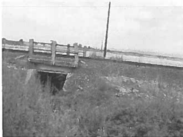
Foto 21: via del ponte ferroviario della linea ferroviaria Cagliari-Sassari-Golfo Aranci, visto dal limite del piazzale di via Dello Sport, lo scorrimento dallo sbocco dello scatolare al ponte avviene con sezione a cielo aperto, lo sbocco e il ponte non sono allineati.
