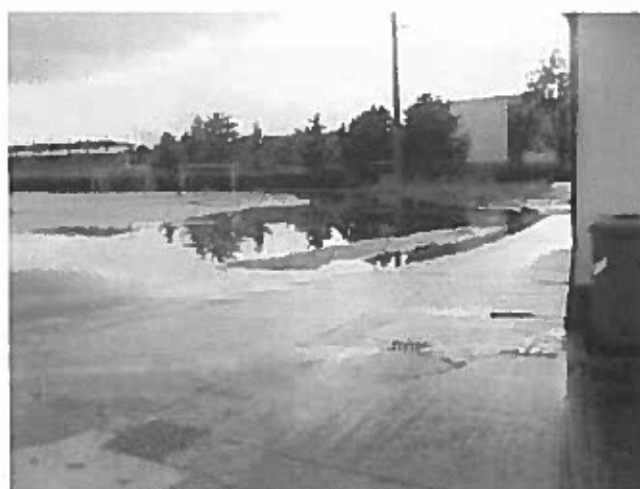
Foto n.6: Evento del 17.06.2015 ore 19:43 Vista dalla sezione 2 del Tronco critico 'Canalizzazione' all'interno del campo sportivo comunale – evento terminato da circa 20-25 min
