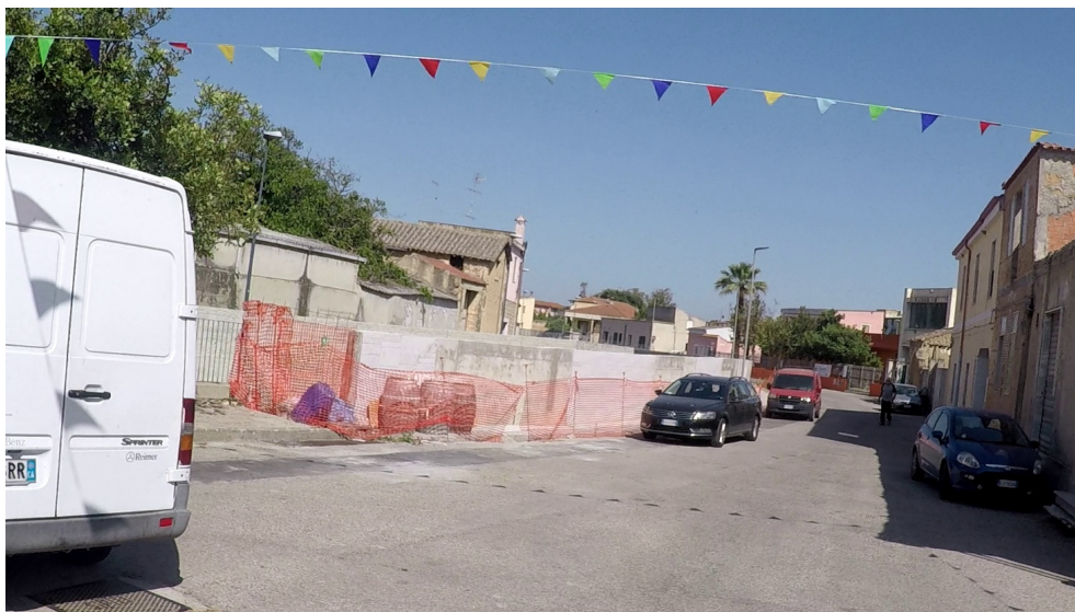
Foto 1 e 2. I muri realizzati, non riportati nei documenti di progetto.
