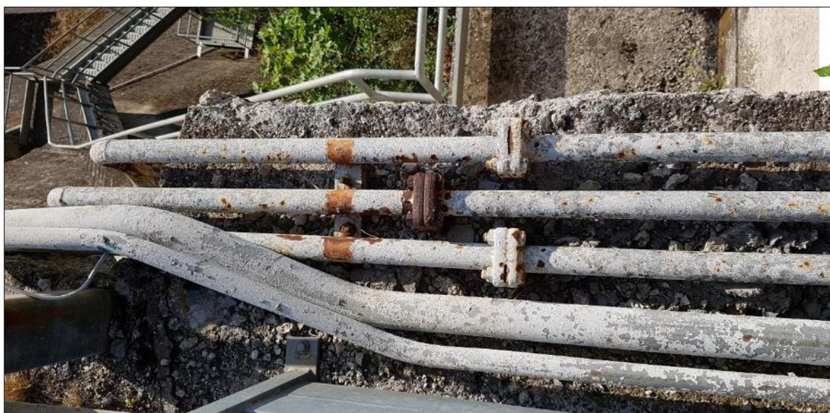
Figura 19 – Scarico di superficie – Tubazioni d'olio tra la centrale oleodinamica e le ventole e linee elettriche
