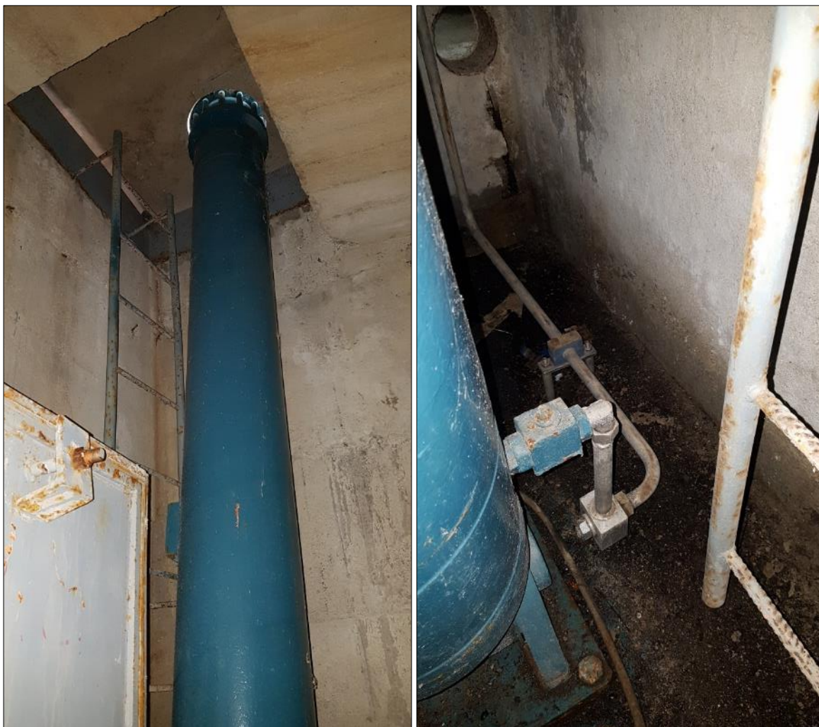
Figura 23 – Camere stagne di alloggiamento dei pistoni a servizio delle ventole
