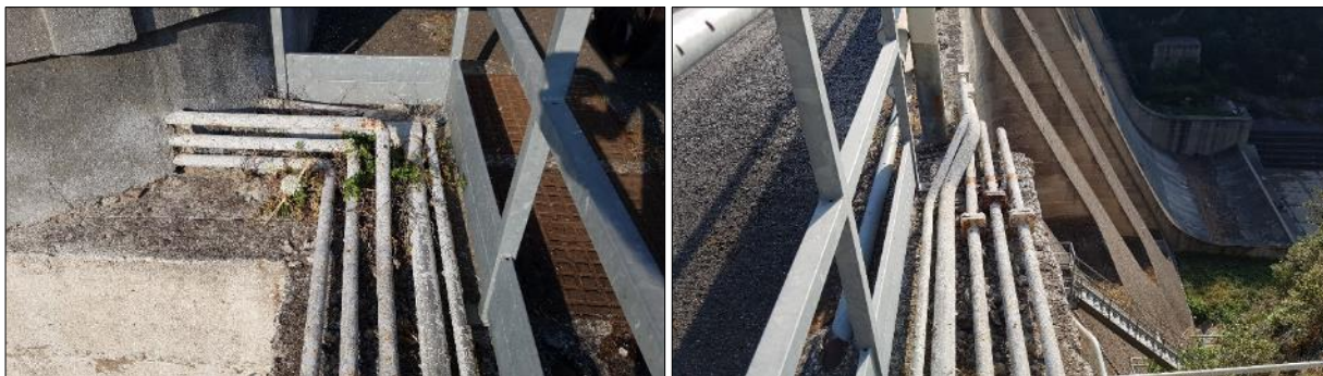
Figura 18 - Scarico di superficie – Tubazioni d'olio tra la centrale oleodinamica e le ventole e linee elettriche
