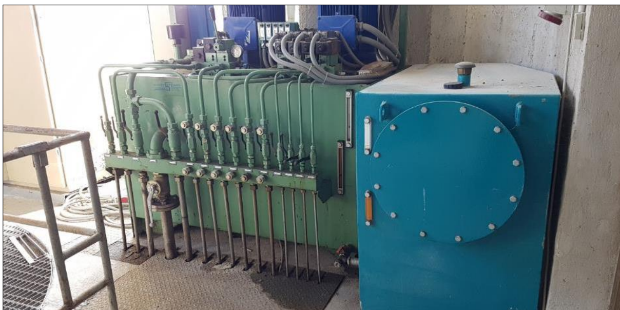
Figura 15 – Camera di manovra – Centralina oleodinamica e serbatoio supplementare
