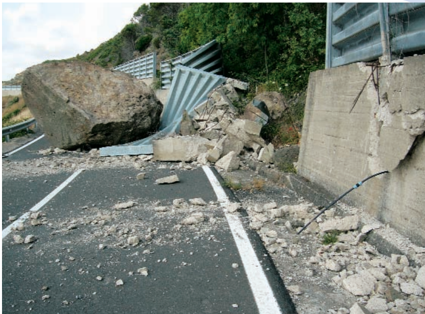
Punta Spinosa Strada Statale n°134 (tratto Castelsardo-Sedini) blocchi di Ignimbrite (fino a 50mc) hanno invaso la sede stradale dopo aver rotolato sul versante per circa 100 m, aver travolto il muro di cemento armato e la barriera paramassi.
