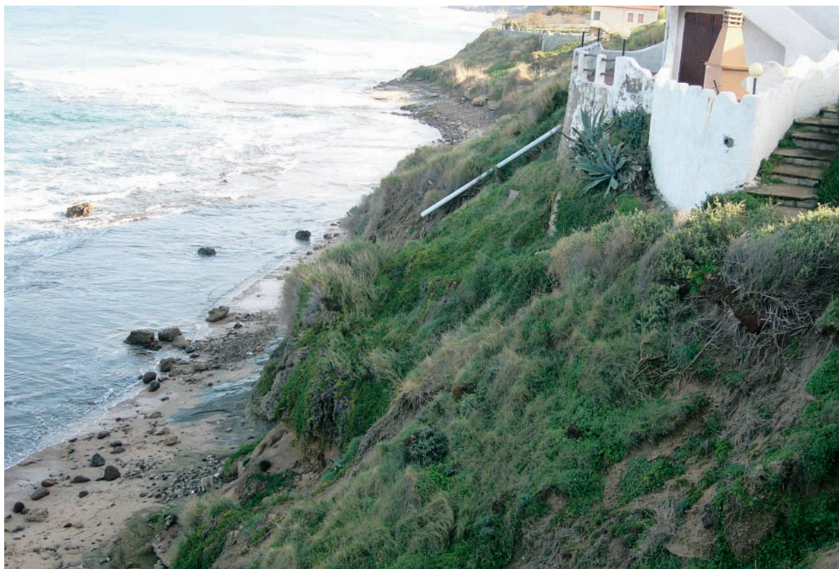
Fenomeni franosi complessi con crolli al piede della falesia di La Ciaccia (Valledoria) innescati da piogge intense.
