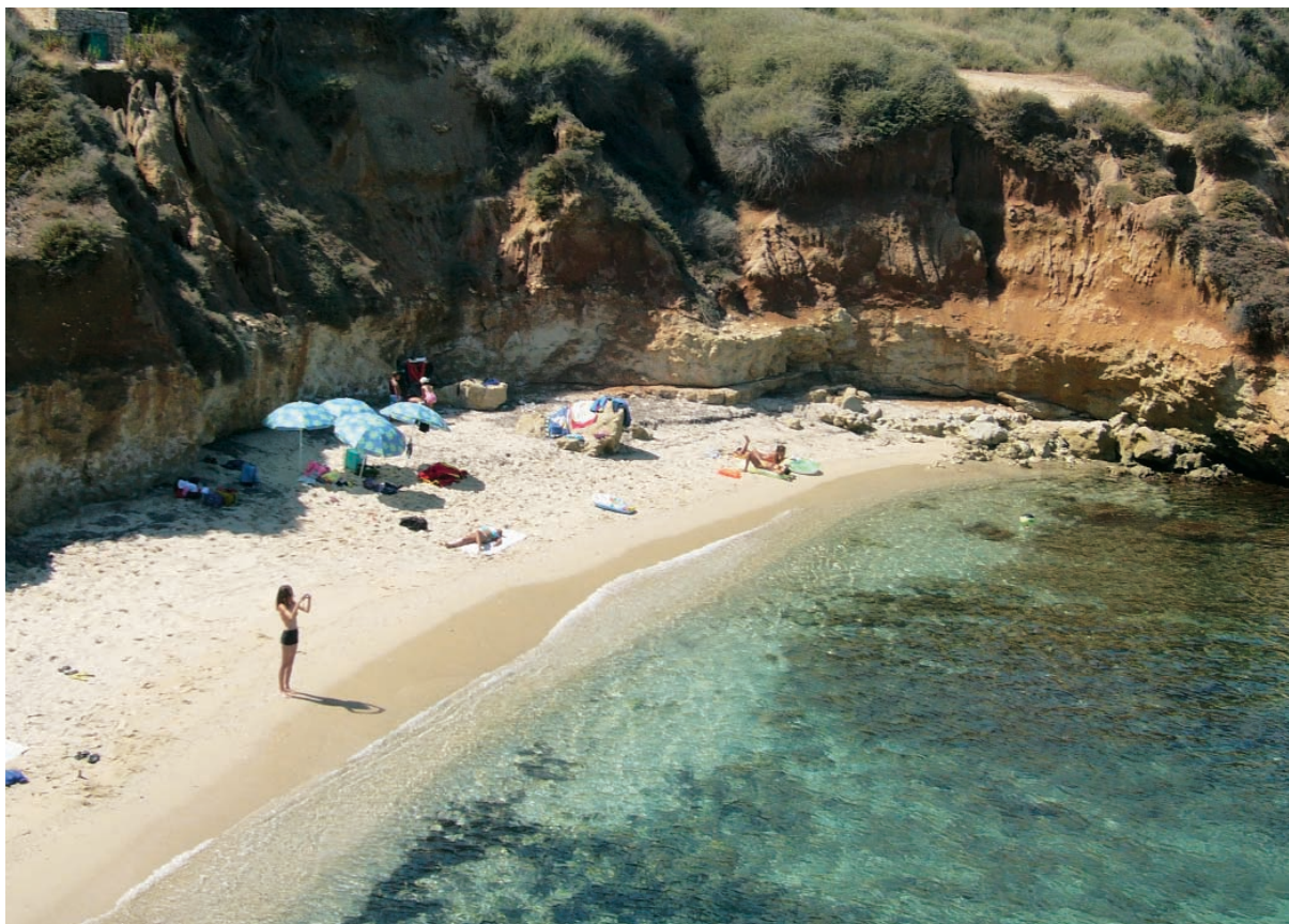
Frane di crollo associate a fenomeni erosivi presso litorale di San Gavino a mare (Porto Torres).
