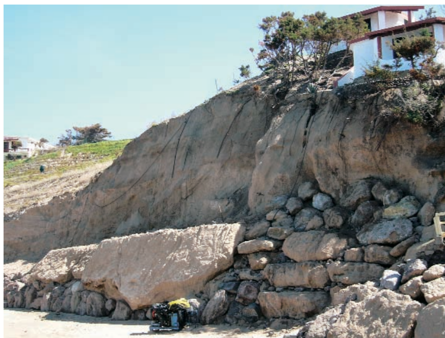
Castelsardo (SS), località Li Paddimi Intervento di consolidamento a carico di una parete esposta a crolli e ribaltamenti diffusi di prismi (dune fossili pleistoceniche) dovuti a scalzamento alla base per degrado progressivo da esposizione (NW) ai venti, aerosol e contributo probabile dell'ondatazione.
