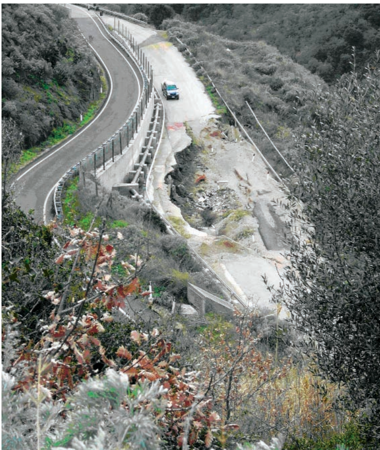
Comune di Ittiri (SS), Strada provinciale n°41 bis Ittiri-Banari Frana di Scivolamento rotazionale unita a crollo su ignimbriti lapidee, a carico di un sostrato alterato di piroclastiti.
