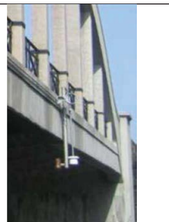
Idrometro in centro ponte lato valle
