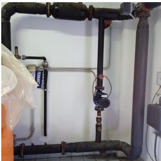
Centrale termica - Linea acqua calda da caldaia
