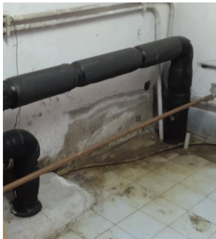
Tubazioni dalle pompe di calore "linee interrate"
