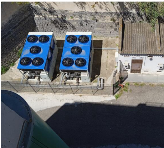
Pompe di calore esistenti
