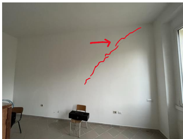
9. Aula esposta a sud con problemi di fessurazioni e distacco dell'intonaco
