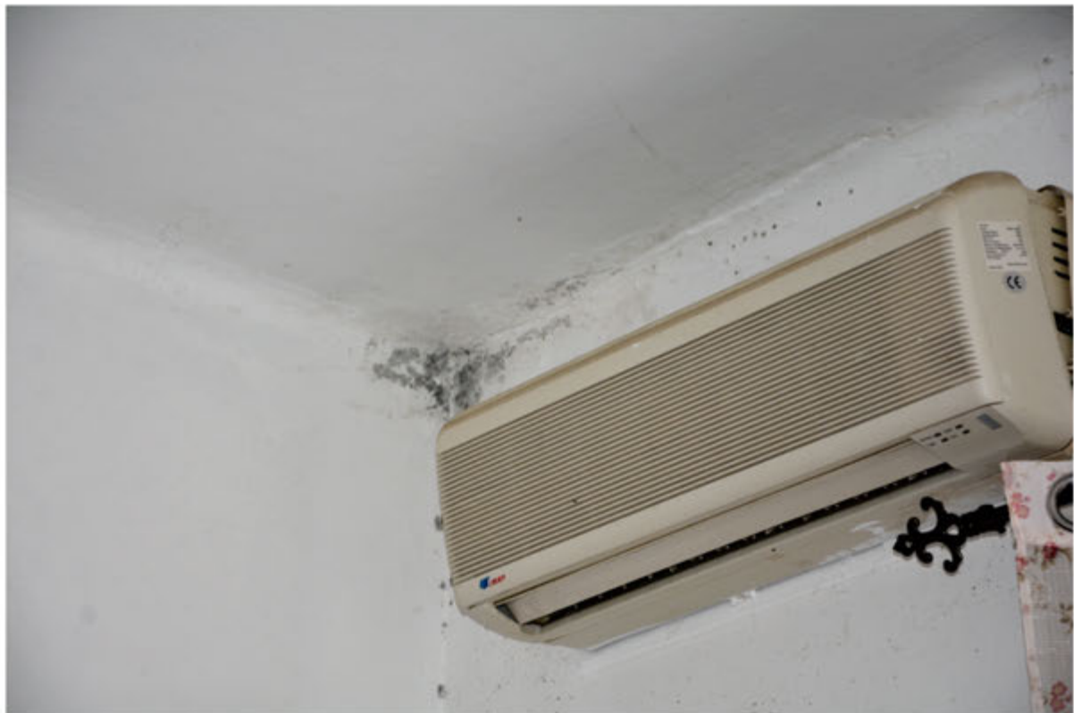
Foto 40: Unità immobiliare 3 - Split non funzionante - Foglio 37 mapp.1973 sub.6
