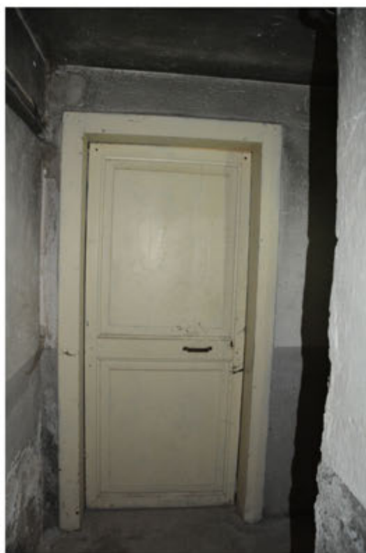
Foto 44: Unità immobiliare 6 - Porta d'accesso alla cantina - Foglio 37 mapp.1973 sub.16
