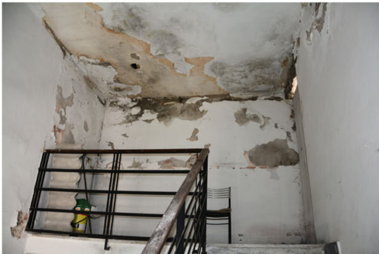
Foto 31: Unità immobiliare 3 - Plafond in degrado nel corpo scala - Foglio 37 mapp.1973 sub.6
