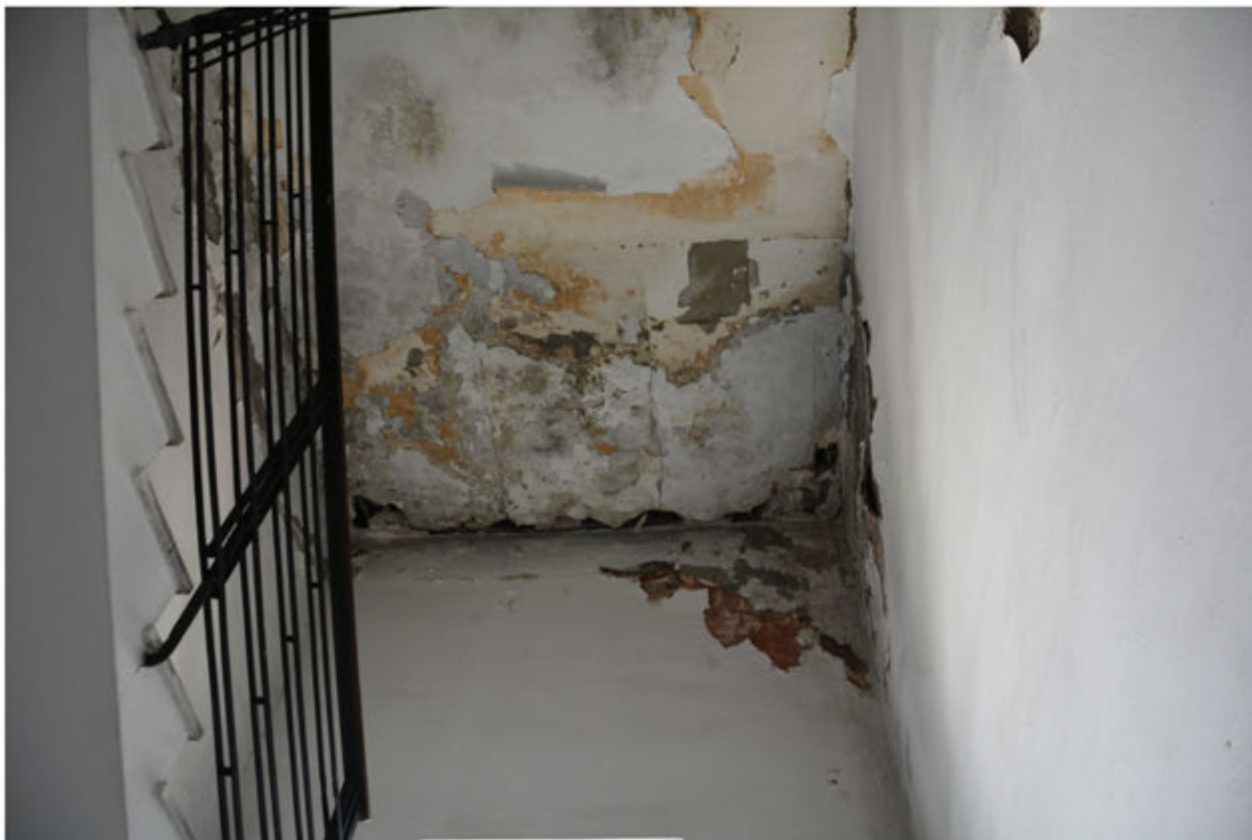
Foto 30: Unità immobiliare 3 - Plafond in degrado nel corpo scala - Foglio 37 mapp.1973 sub.6
