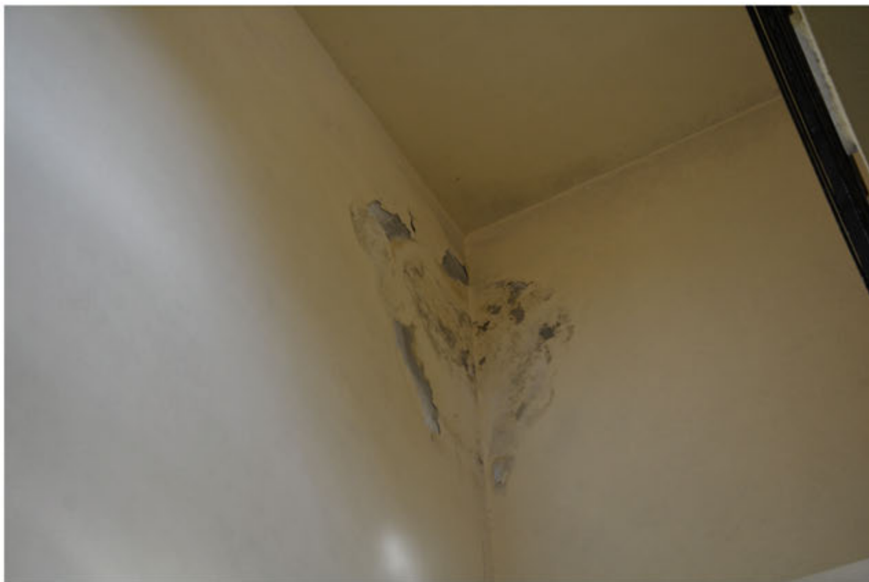
Foto 10: Unità immobiliare 1 - Umidità corpo scala - Foglio 37 mapp.1973 sub.3
