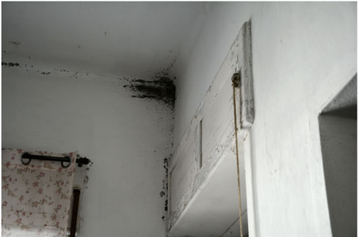
Foto 39: Unità immobiliare 3 - Evidenti tracce di muffa in cucina - Foglio 37 mapp.1973 sub.6
