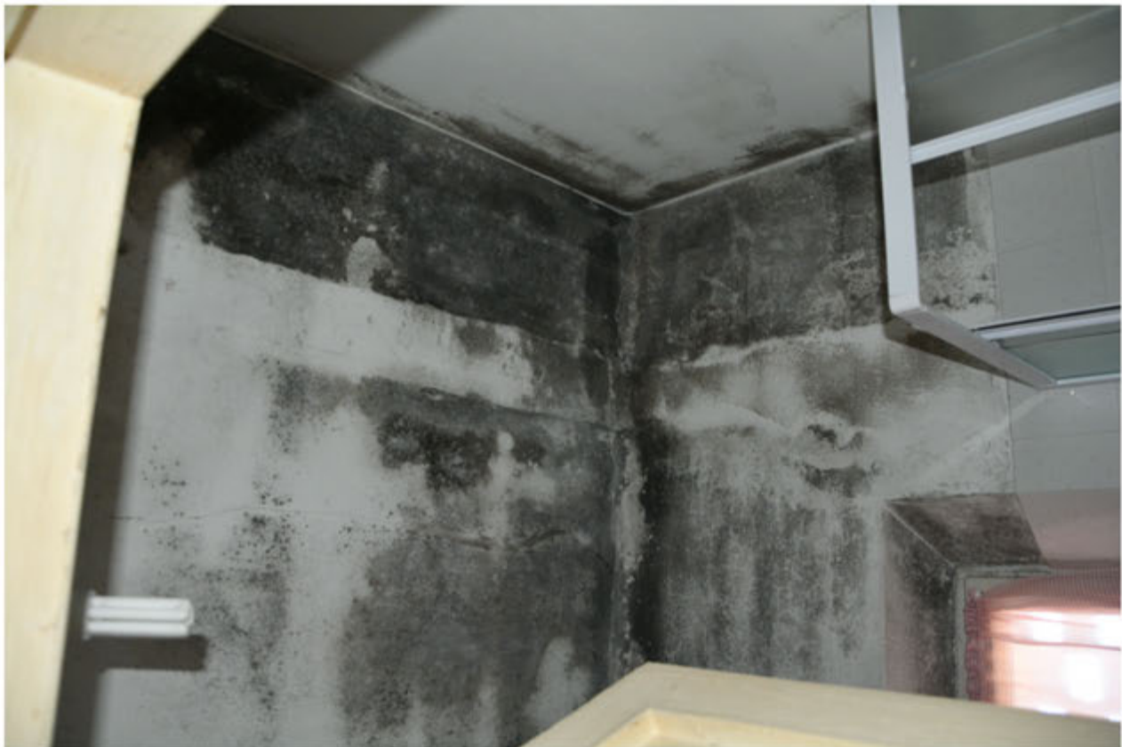
Foto 40: Unità immobiliare v3 - Umidità ripostiglio - Foglio 37 mapp.1973 sub.6
