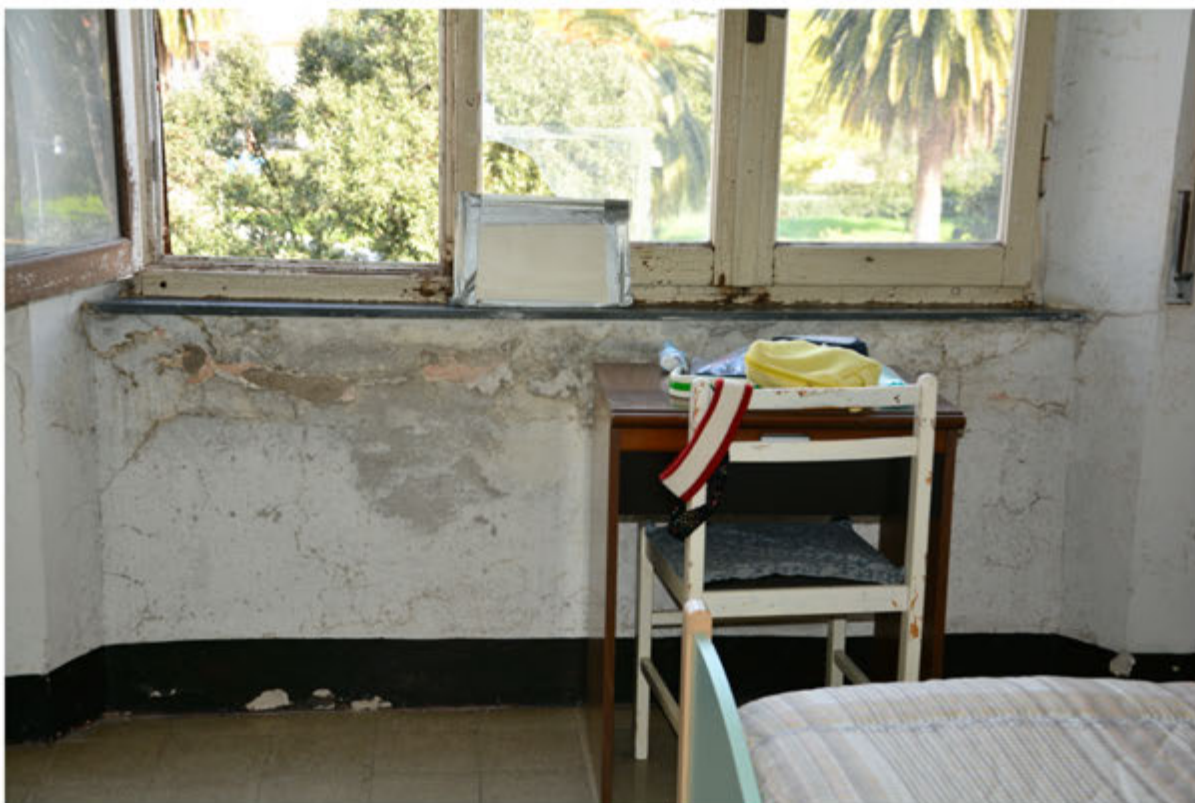
Foto 18: Unità immobiliare 1 - Umidità interna - Foglio 37 mapp.1973 sub.3
