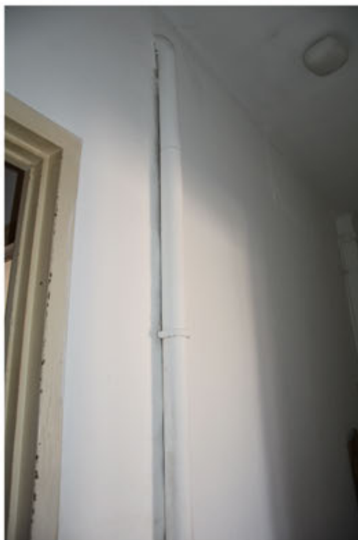
Foto 37: Unità immobiliare 3 - Tubazioni interne all'appartamento - Foglio 37 mapp.1973 sub.6
