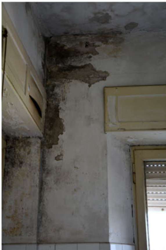
Foto 19: Unità immobiliare 1 - Umidità interna - Foglio 37 mapp.1973 sub.3
