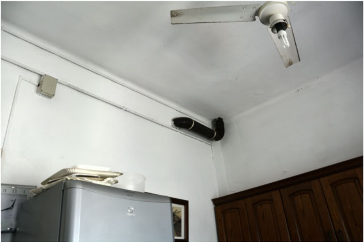
Foto 40: Unità immobiliare 3 - Tubazioni interne all'appartamento - Foglio 37 mapp.1973 sub.6
