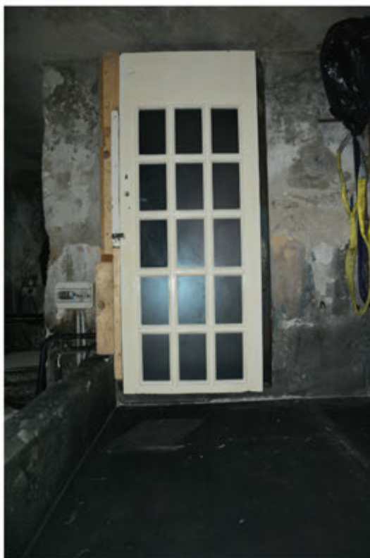
Foto 43: Unità immobiliare 5 - Porta d'accesso alla cantina - Foglio 37 mapp.1973 sub.8
