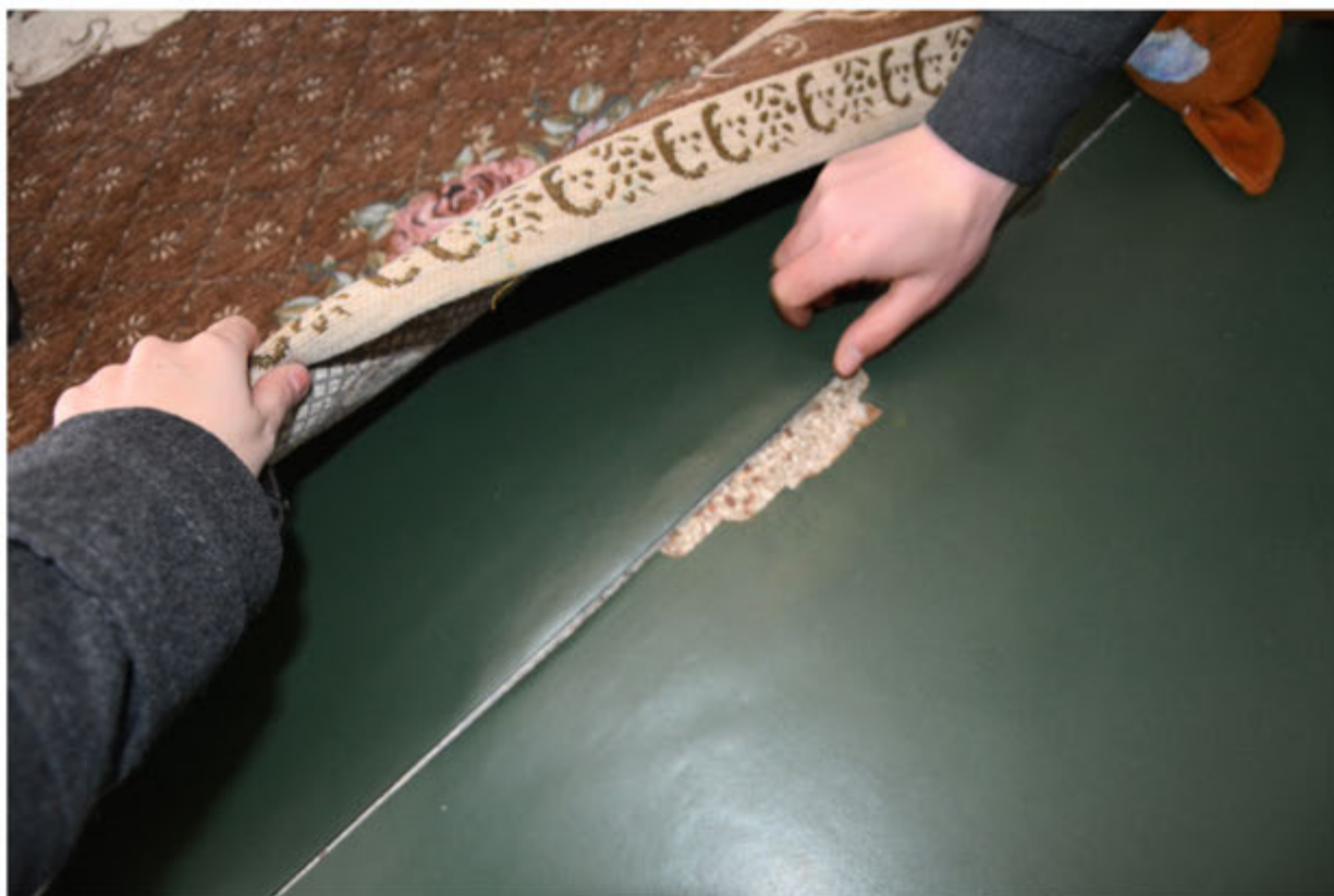
Foto 36: Unità immobiliare3 - Pavimentazione - Foglio 37 mapp.1973 sub.6
