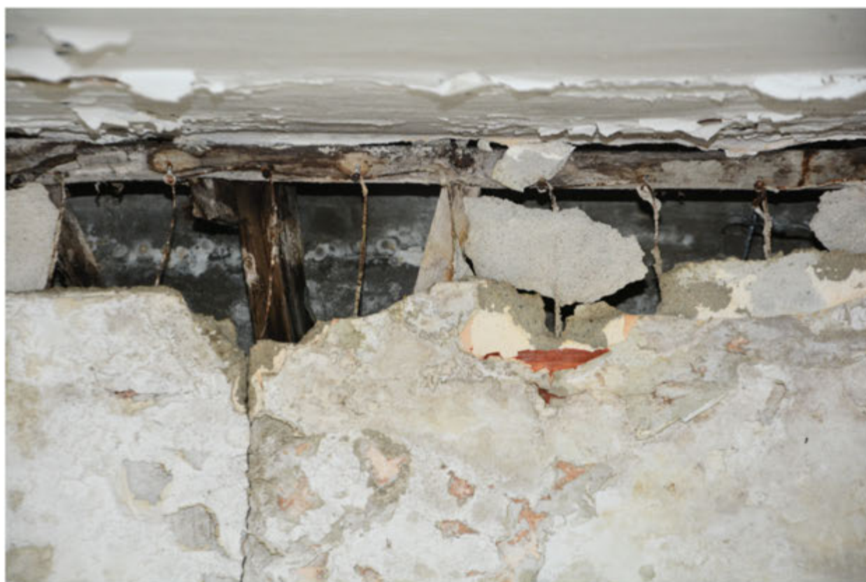
Foto 32: Unità immobiliare 3 - Plafond in degrado nel corpo scala - Foglio 37 mapp.1973 sub.6
