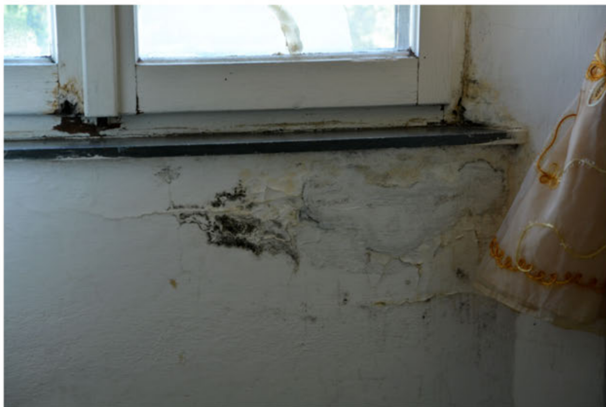
Foto 40: Unità immobiliare 3 - Umidità camera da letto - Foglio 37 mapp.1973 sub.6
