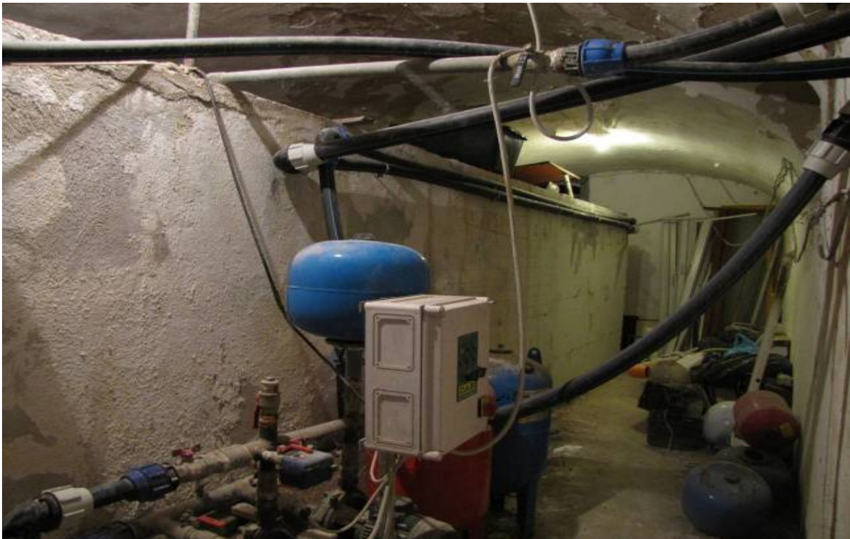
Locale tecnico al piano interrato
