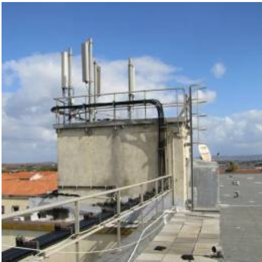
Particolari delle strutture del ponte radio di telefonia mobile
