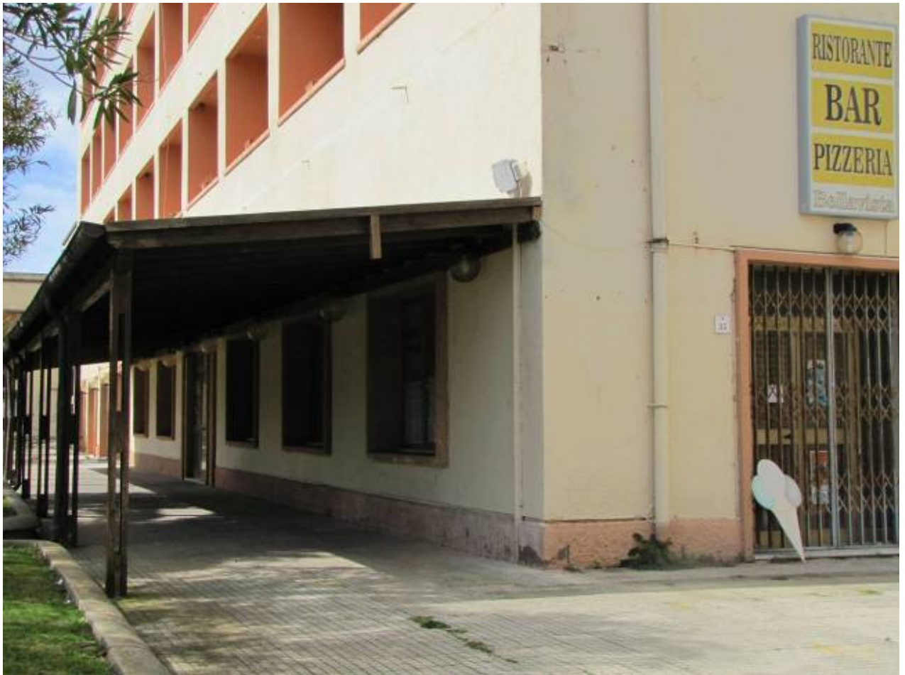
Veranda in legno abusiva sul fronte principale
