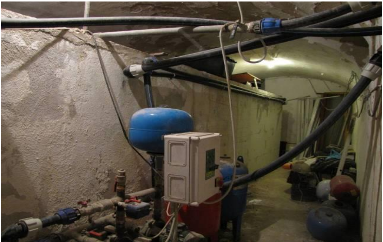
Locale tecnico al piano interrato
