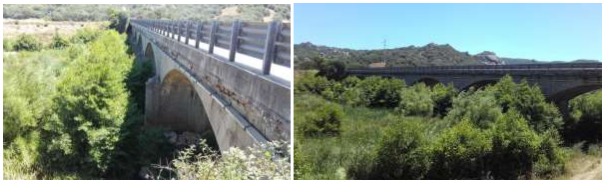
Figura 6 –Esemplari di specie arboree vegetanti a ridosso del paramento di valle di un attraversamento (in foto Ponte Liscia lungo la SS133).
